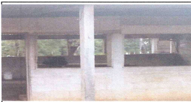
Foto 5: MURO DE CONTENCIÓN EN MAL ESTADO QUE NECESITA SER REPARADO CON FUNDICIÓN.
