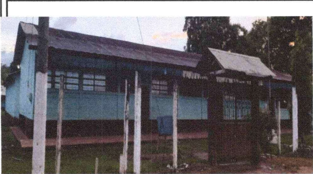
Foto1: LÁMINAS DETERIORADAS DEL ENTECHADO, QUE NECESITA SER SUSTITUIDO POR LÁMINAS TROQUELADAS.
