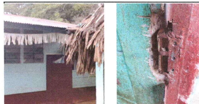
Foto 6: AULAS CON PUERTA SEMIABIERTAS POR CHAPAS EN MAL ESTADO QUE REQUIERE CAMBIOS
