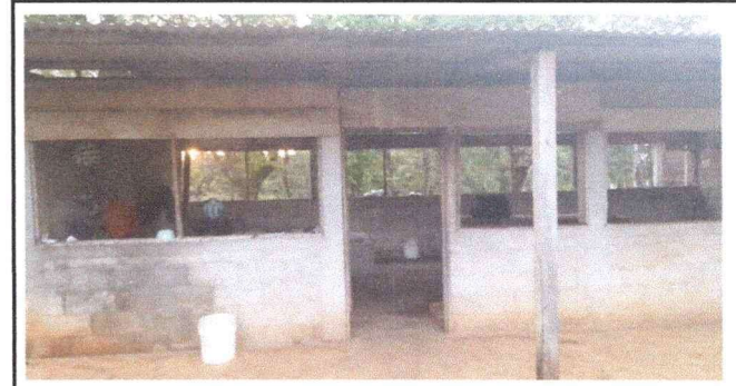
Foto 4: MALLA EN MAL ESTADO EN LAS VENTANAS DE COCINA, NECESITA SER CAMBIADA POR BALCONES DE METAL.
